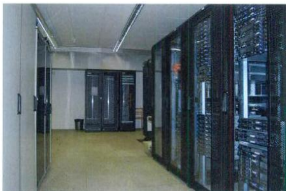
Blick in das hochmoderne swisspro-Rechenzentrum in Chur.
