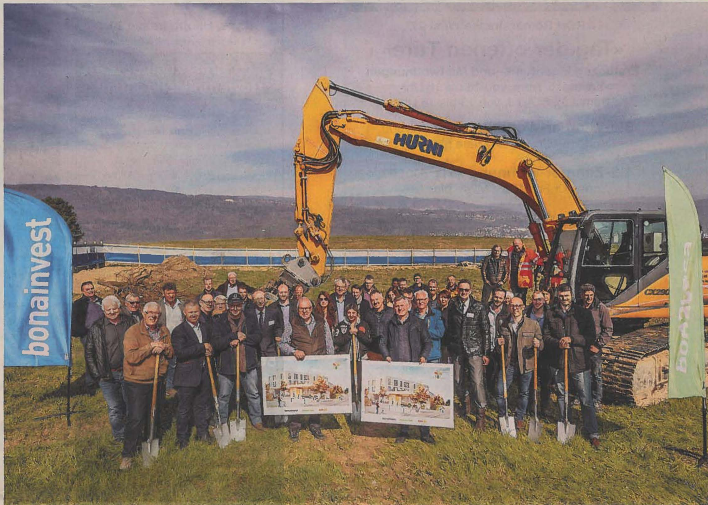
Der Bagger steht bereit: Mit mehreren Spaten besiegeln die Mitwirkenden den Baustart des Projekts Drüblatt.
