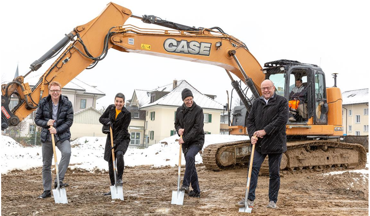
Spatenstich für die Überbauung Strahnhof am 1. Dezember 2020 (Foto: Susann Reinhard Fotografie) V.l.n.r.: Stefan Graf, Bauart Architekten und Planer; Liliane Weisenseel, Die Hausärztinnen Münchenbuchsee AG; Adrian Sidler, bonainvest AG; Manfred Waibel, Gemeindepräsident
